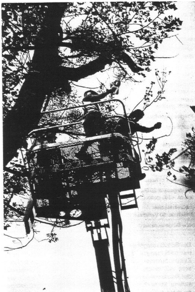
Abb.3: Erst im Jahr 1990 hat die Stadt Salzburg einen sogenannten „Ruthmannsteiger“ erworben, mit dem sich Arbeiten im Kronenbereich der Bäume leichter und schonender durchführen lassen.
